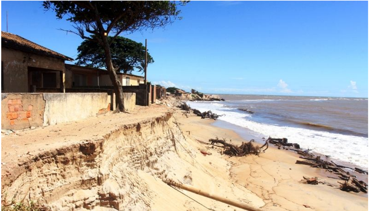
Figura 3 — Processo erosivo em Atafona.
