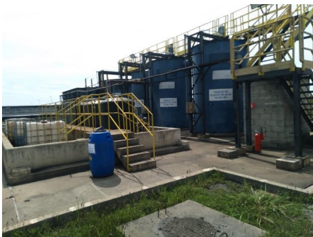
Figura 5.5 – Estação de Tratamento de Efluentes Industriais - ETEI
