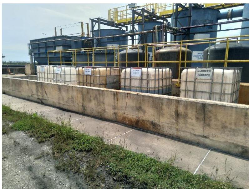
Figura 5.4 – Produtos Químicos utilizados na Estação de Tratamento de Efluentes Industriais - ETEI
