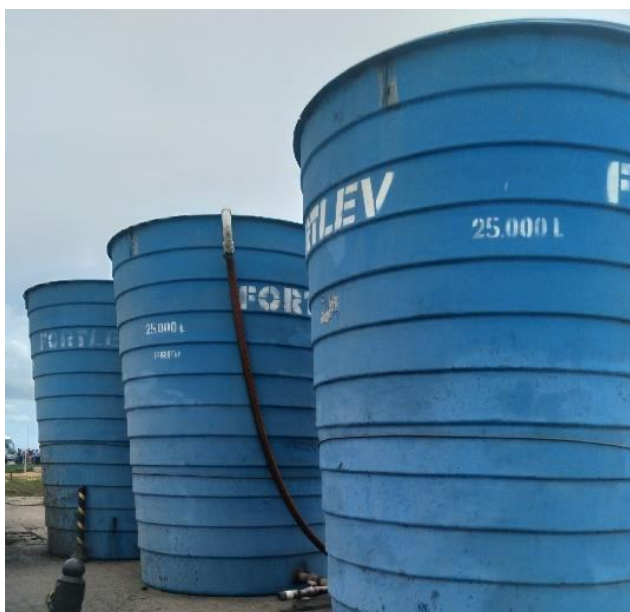
Figura 5.8 – Tanques de armazenamento dos efluentes provenientes das operações com fertilizantes
