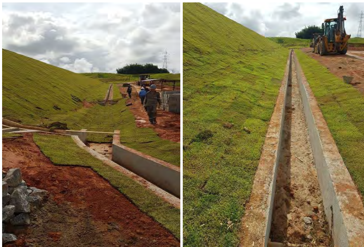
Foto 7.2.4-2 Sistema de drenagem superficial nos Lotes 46 e 47 do CLIMA, a exemplo de como serão entregues os Lotes das futuras UTEs Litos 1, 2, 3 e 4.
