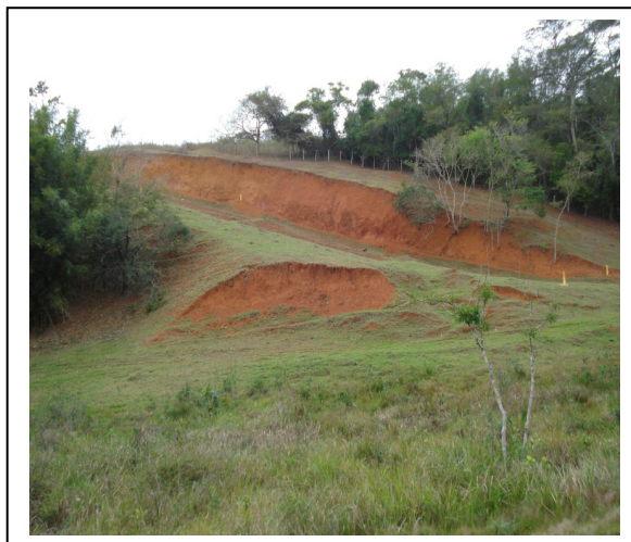
Desmoronamento em taludes devido à maior Suscetibilidade à erosão de Argissolo Vermelho.
