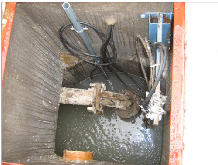
Infra-estrutura de Tratamento de Esgoto dos Condomínios.
