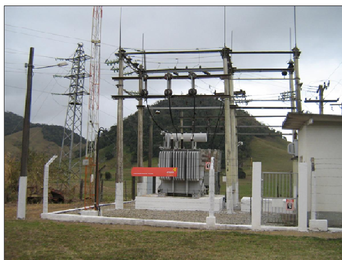
Subestação Almeida Pereira.
